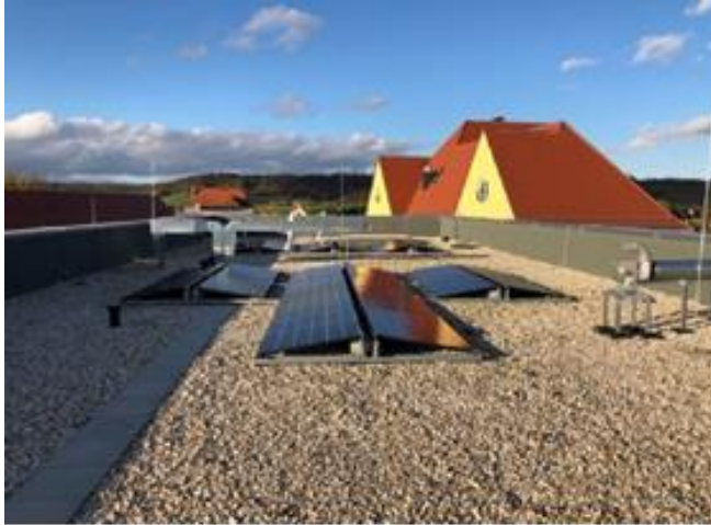
Abb. 3: Photovoltaikanlage Staatliche Gemeinschaftsschule Bürgel
